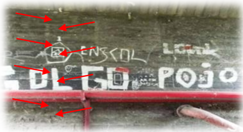
(b). Retakan Memanjang pada Dinding
