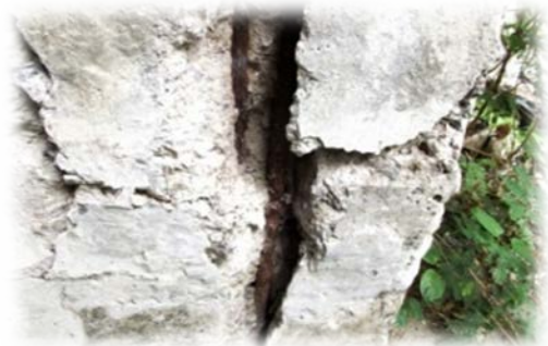
(b). Delaminasi (Pengelupasan) pada Dinding Beton
