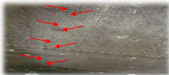
(c). Retakan Memanjang pada Sisi Bawah Pelat
