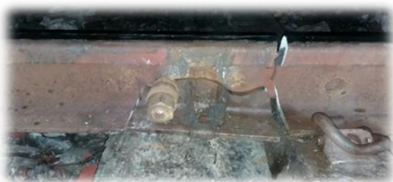
Gambar 2. Kerusakan di Sekitar Sambungan Rel Setelah Pemakaian
